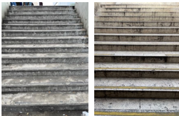
Imagens 34 e 35 – Escadas pedonais em mau estado.
