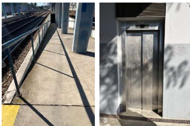
Imagens 77 e 78 – Contumil – Barreiras arquitetónicas. Piso bastante inclinado e largura estreita das portas do elevador.
